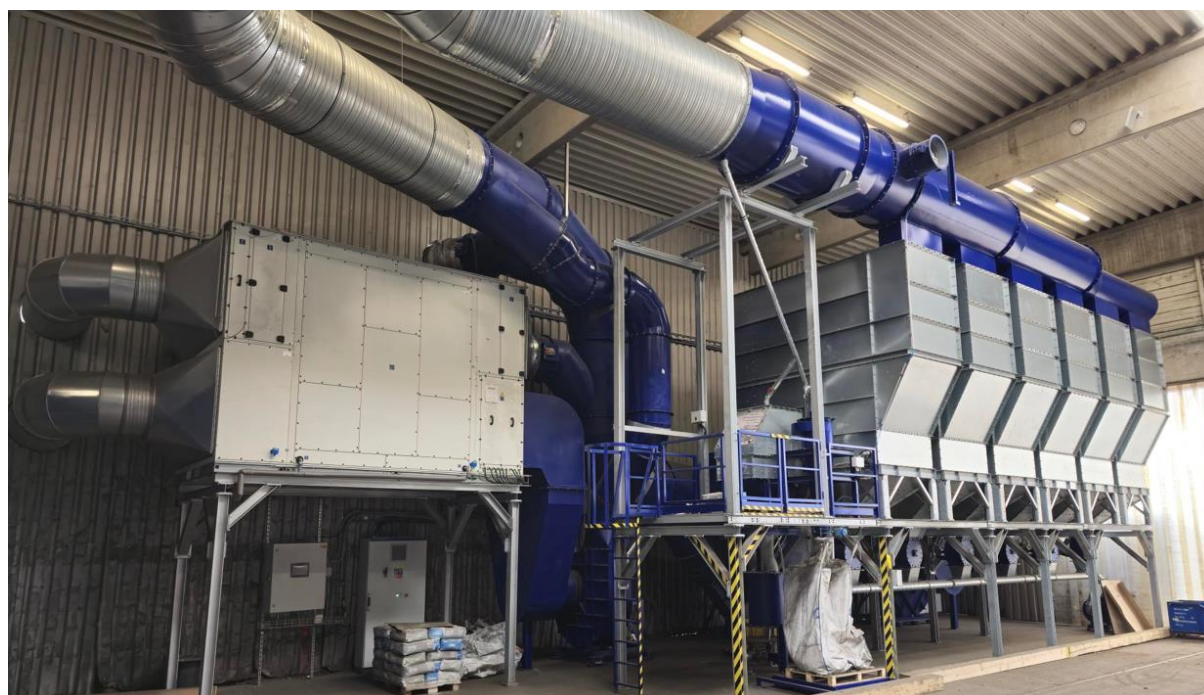
Obrázek 6 Filtrační zařízení s přívodní rekuperační jednotkou
