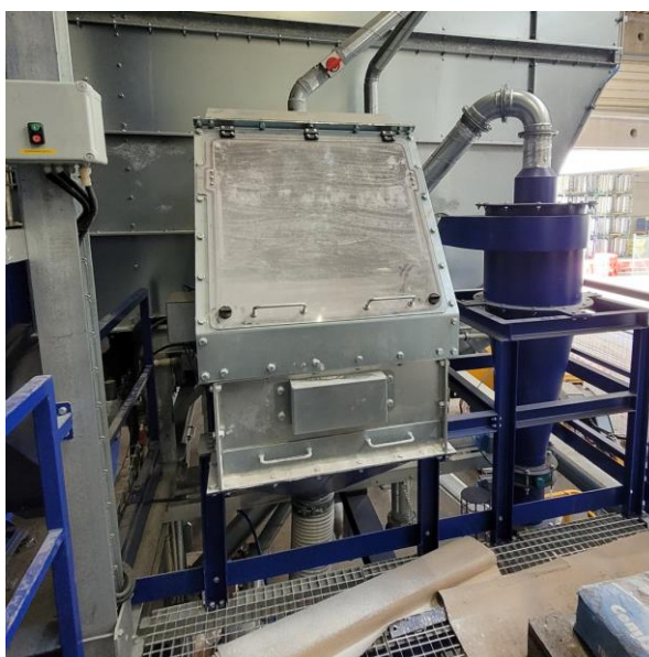
Obrázek 2 Stanice pro dávkování sorbentu do zásobníku
