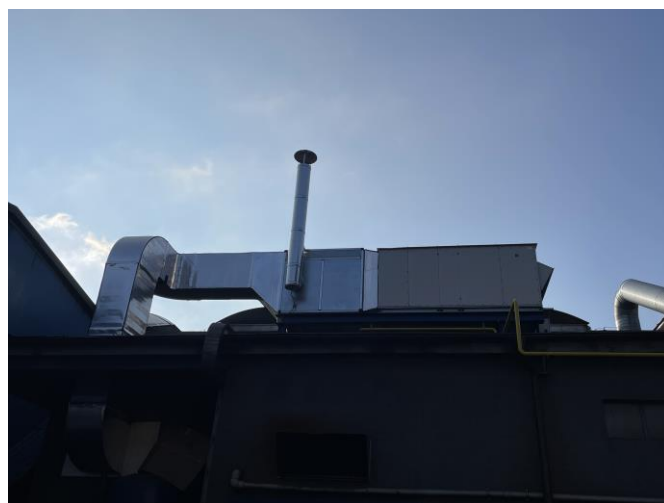
VZTZ jednotka, přívod čerstvé vzdušiny do jaderny
