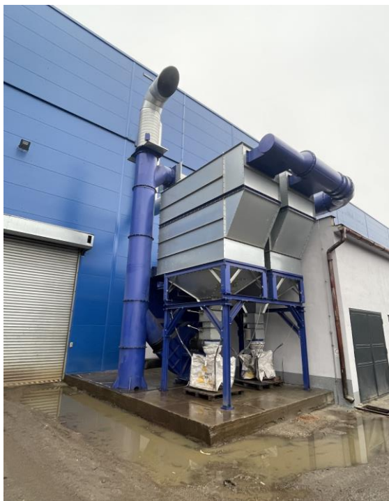
F12, odprášení ručních pracovišť čistírny
