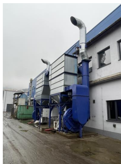
F13, F14 odprášení ručních pracovišť čistírny
