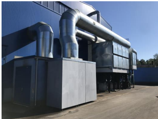
Filtrační zařízení F 12 pro záchyt TZL z odprášení pracovišť cídírny
