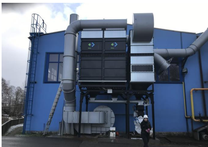
Filtrační zařízení pro záchyt TZL z odprašení tavící plynové pece 5tun
