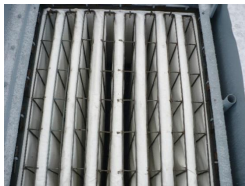
Dodávka a výměna kapsových filtrů i pro konkurenční zařízení.
